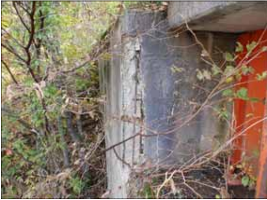
写真-1 コンクリート部の劣化
