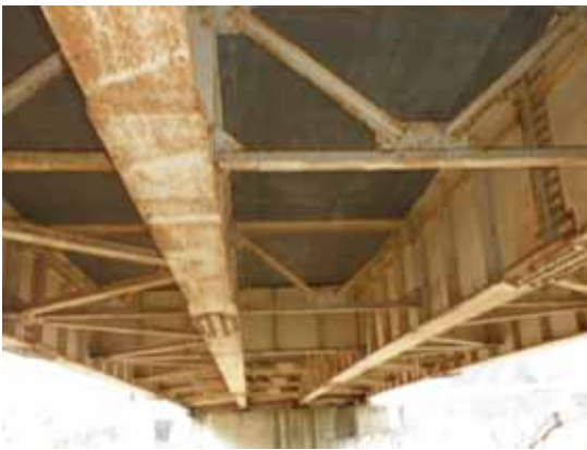
写真-5 鋼橋の劣化状況
