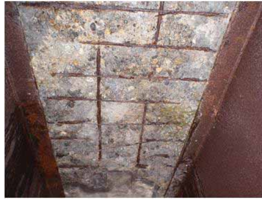
写真-2 床版の損傷
