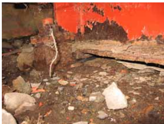
写真-8 支承の劣化
