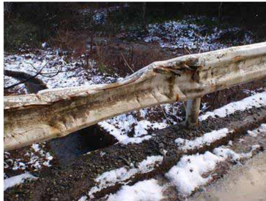
写真-4 防護柵の損傷
