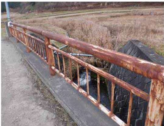
写真-3 防護柵の劣化
