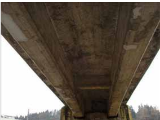
写真-7 コンクリート橋の劣化状況
