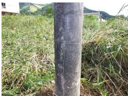
<橋脚のひび割れ>
