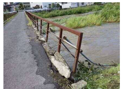
<防護柵劣化・腐食>
