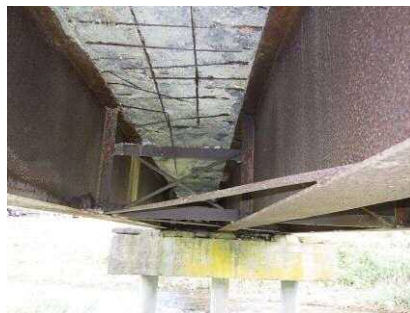
<床板鉄筋露出・破断>
